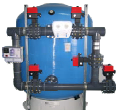
Filtro con batería de válvulas automáticas eléctricas
